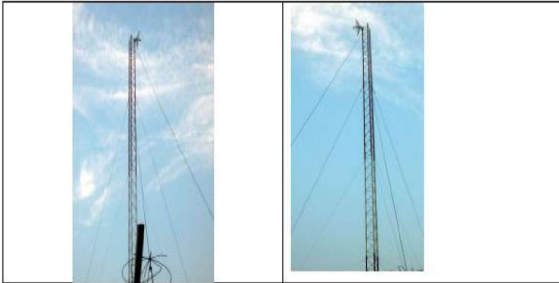
Figura 4.- Torre de Comunicación con antenas Ubiquiti
