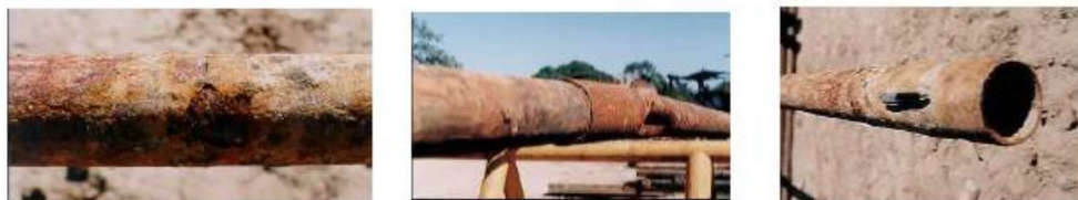
Figura 7. Corrosión combinada H 2 S y CO 2
