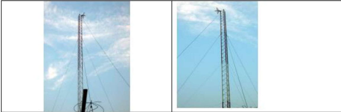
Figura 4. Torre de Comunicación con antenas ubiquiti
